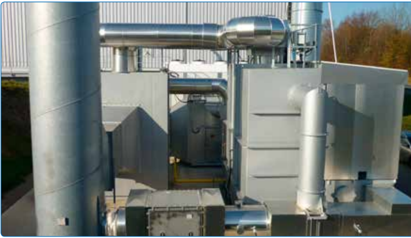
Abluftreinigungsanlage mit Adsorptionsrad
