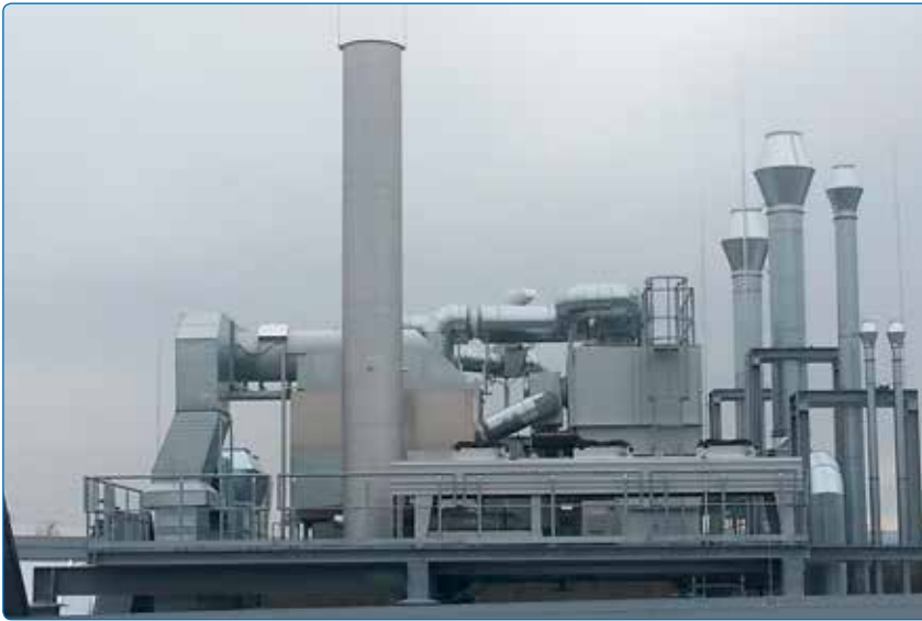
Ressourcen schonende Reinigung großer, schwach VOC-beladener Ablüfte
