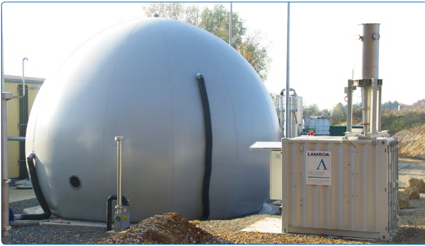
LAMBDA CHC an einer Vergärungsanlage
